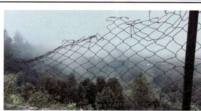
Foto2: Estructura de malla en mal estado
