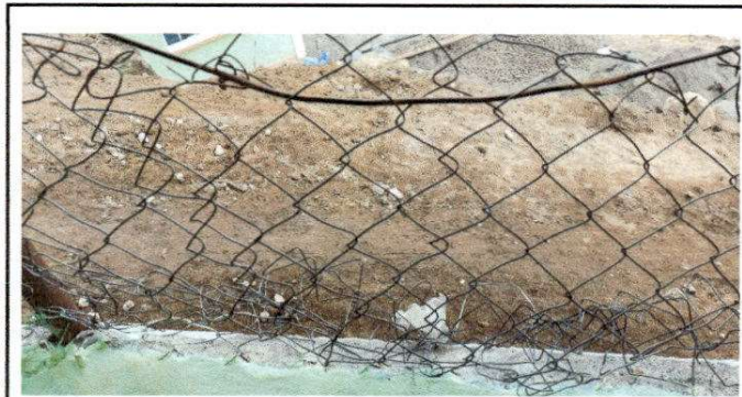
Foto1: Estructura de malla en mal estado
