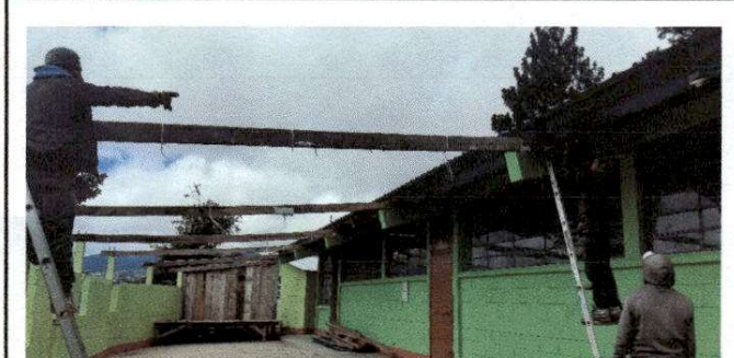
Foto 3: Sustitución de lámina por lámina troquelada aluzinc calibre 26 y sustitución de estructura
