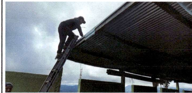
Foto 1: Sustitución de lámina por lámina troquelada aluzinc calibre 26 y sustitución de estructura
